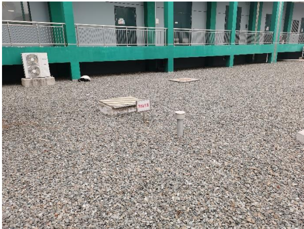
现有事故油池
